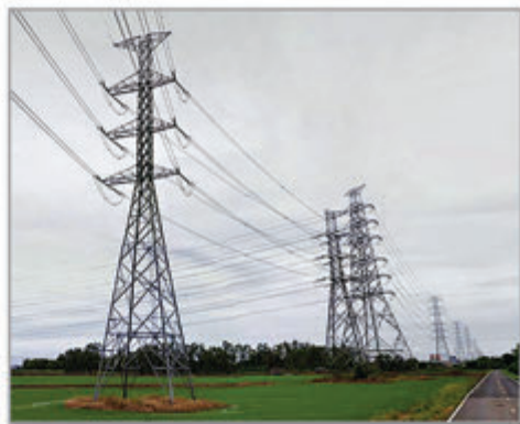
เสาไฟฟ้า
