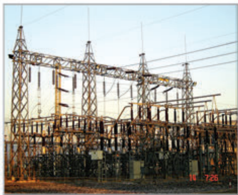
สถานไฟฟ้า
